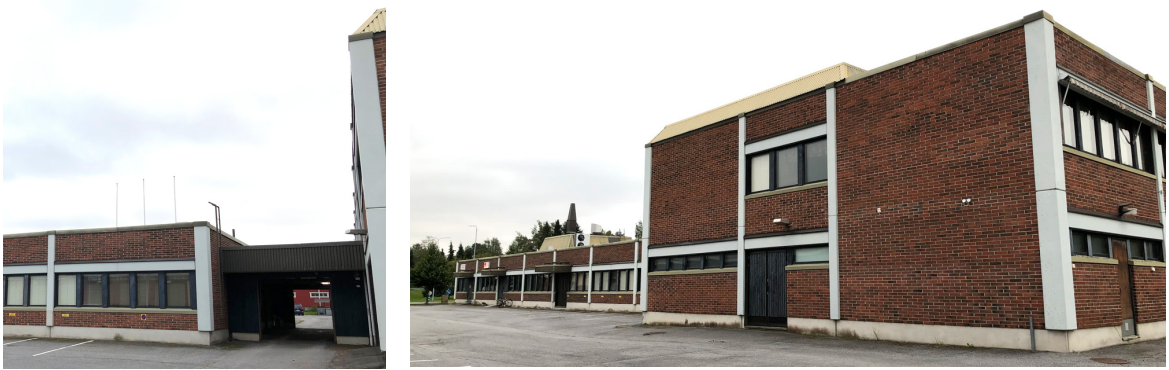
Kuva 10. Virastotalon lounaissivu, vasemmalla näkyy välikkö rakennusosien välillä (Ramboll 09/2023).
